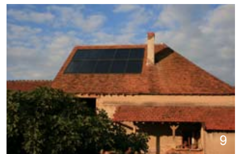
9. Capteurs solaires - Bonnay
