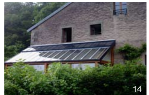
13. Panneaux solaires verticaux 14. Panneaux solaires sur un auvent
